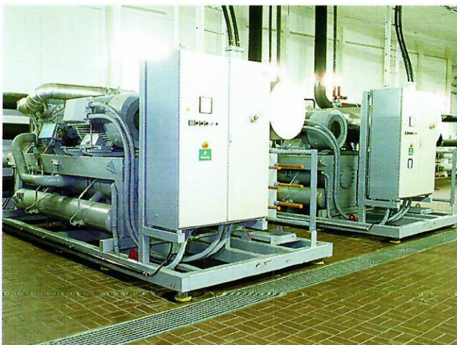
Zwei von drei Flüssigkeitskühlern von SABROE, die in einer großen schwedischen Brauerei eingebaut wurden.
